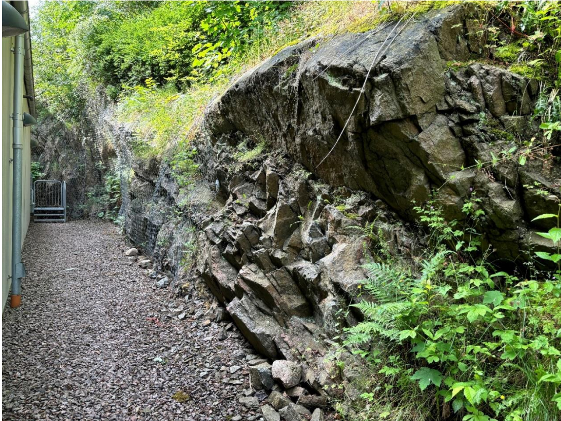
Bild 2 Övanstående foto visar sprängd bergvägg mot Chalmers teknikpark. Den dominerande uppsprickningen längsmed bergmassans gnejsighet ger upphov till överhäng. På grund av lokalt kraftig uppsprickning har bergnät installerats i den borte delen i bilden för att förhindra nedfall av mindre stenar. Norra delen av bergväggen.
